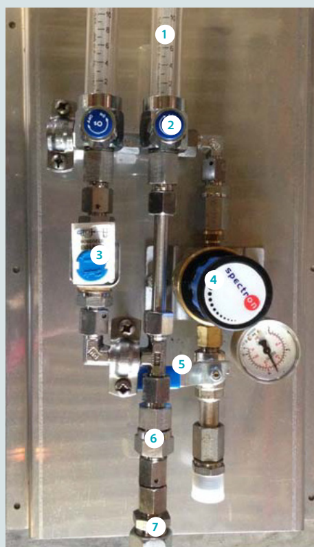
Eksempel på GasDos-panel.
